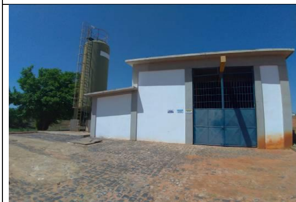
Figura 21 – Estação Elevatória de Água Tratada EEAT 2 do Sistema do Algodão
