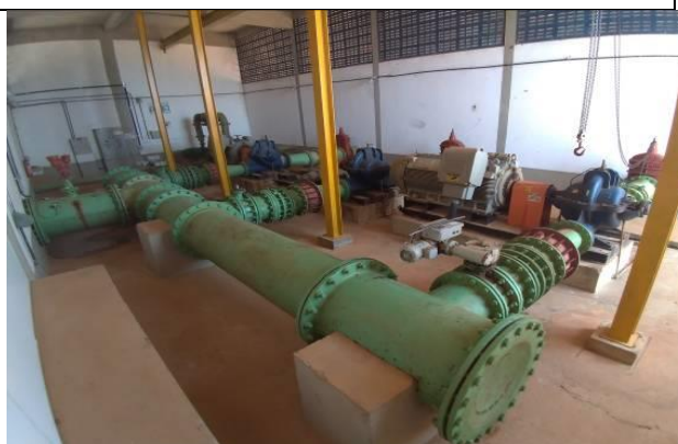
Figura 22 – Conjuntos moto-bombas da Estação Elevatória de Água Tratada 2 do Sistema do Algodão
